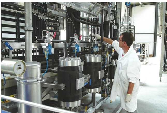
Opérations sur l'équipement pilote SFE / SFF (crédit Boré-Boré)
